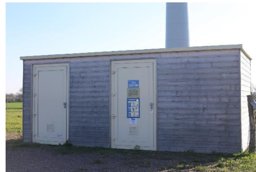
Photo 6 Exemple de poste de livraison
